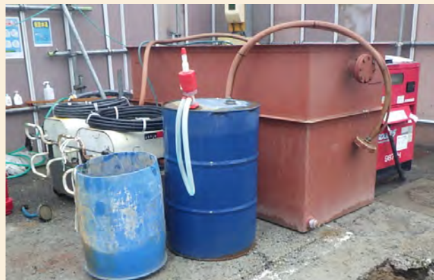
灯油(ドラム缶)の下に防油堤がありませんでした。流出防止のため設置するよう指示しました。
